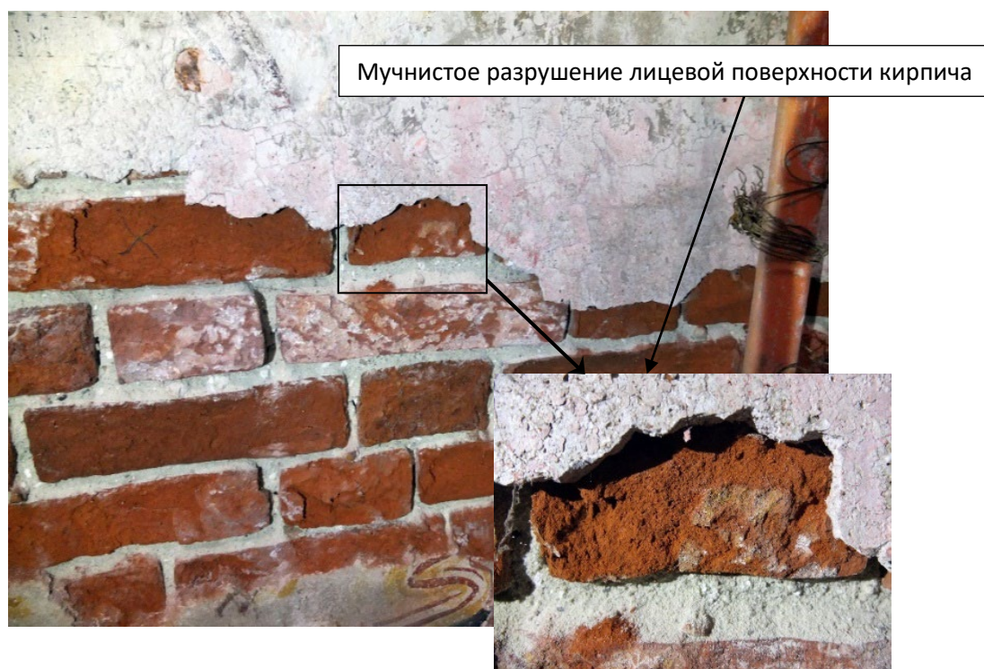
Рисунок 3.5 – Деструкция поверхности кирпича центральной части южной стены церкви Николы Мокрого в Ярославле
