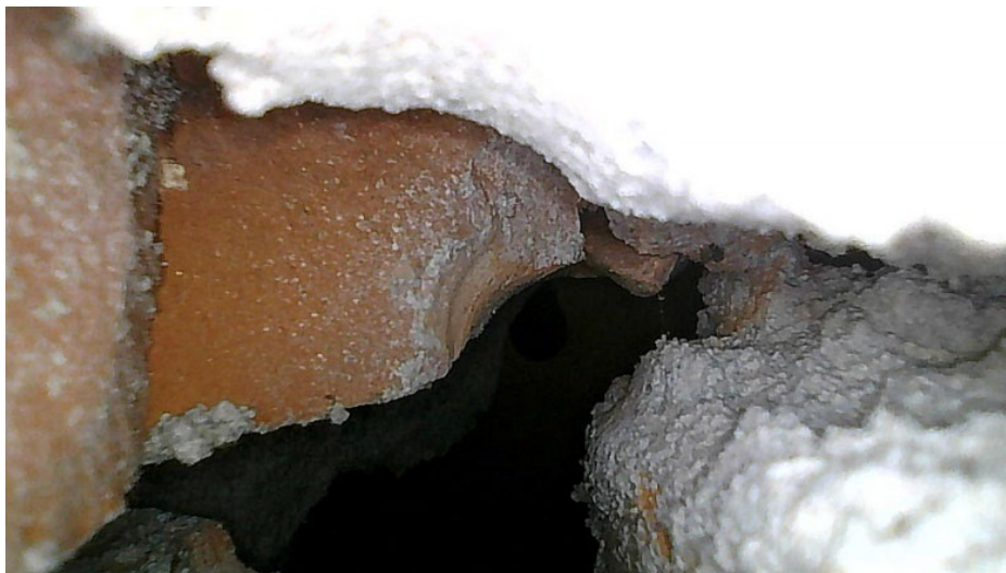
Рисунок 3.22 – Здание гостиницы Духовной Академии СПб. Пустотность в кладке центральной части северной стены на глубине 20,7 см
