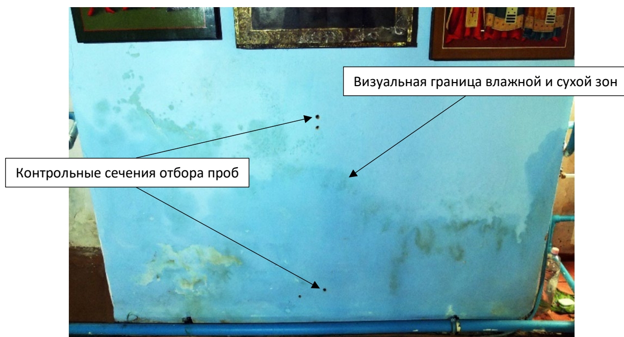
Рисунок 3.1 – Влажная зона в северной части подклета Троице-Знаменской церкви в Лежнево
