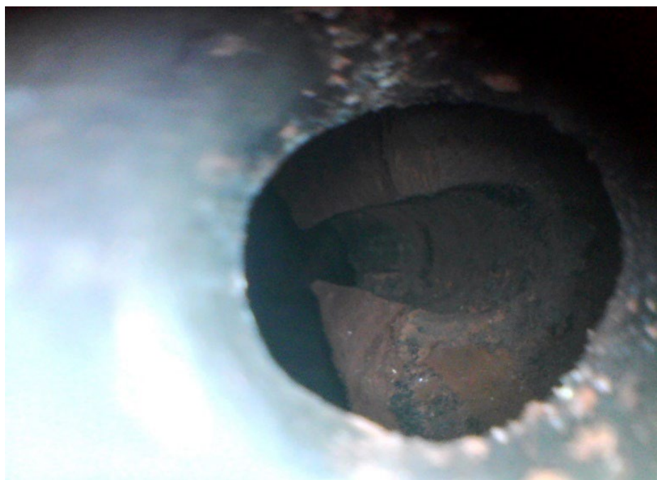
Рисунок 3.23 – Здание библиотеки Духовной Академии СПб. Пустотность в кладке западной части северной стены на глубине 37 см
